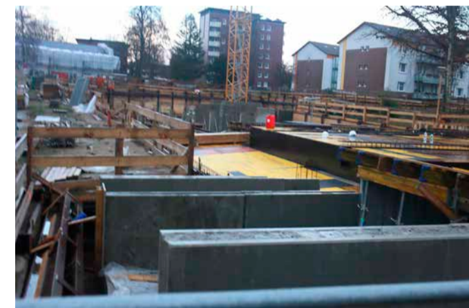
Am Dudenweg gibt es eine große Baugrube für eine Tiefgarage, auf der dann Reihenhäuser neu gebaut werden Foto: Timm
